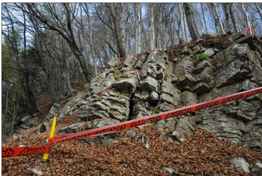
Figura 5 - Uno dei numerosi affioramenti di roccia instabili sul versante ovest del Monte Poieto
